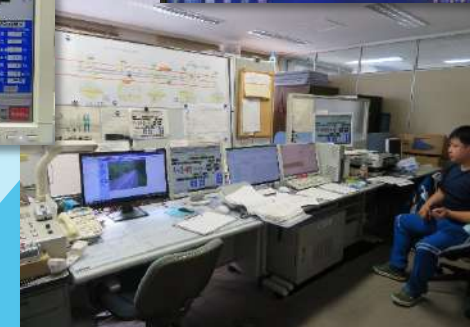
日光宇都宮道路 遠方監視室
